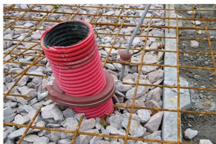
Prostup ošetřený bentonitovým páskem
