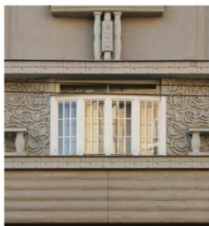
Obr. 5 – Obnova fasády škrábané probarvené ve hmotě na kulturní památce – detail. Kvalitu provedení poznamenala malá zkušenost stavební firmy, které se nepodařilo „vytáhnout“ z omítky rovné vodorovné prvky v takové kvalitě, jako se to podařilo v roce 1913. Obnova škrábaných omítek bez vrchního nátěru je náročná na řemeslnou zručnost. Kompletní výměna omítek je v současné době dobře zvládnutá. V případě částečných oprav bez nátěru jen doplněním poškozených částí, nelze dosáhnout v praxi esteticky kvalitního výsledku. Nátěr této omítky způsobuje ztrátu kulturních hodnot.
