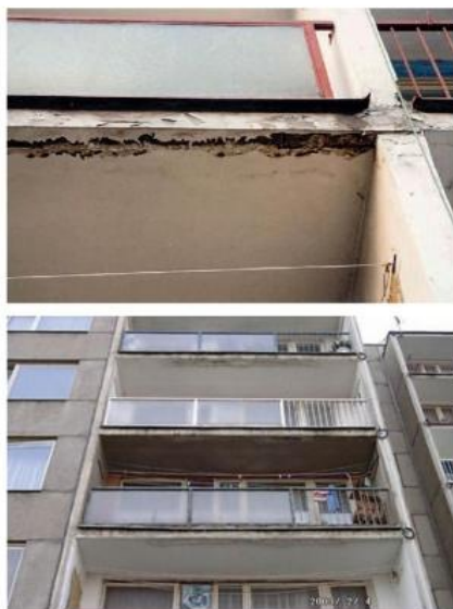
Obr. 3 – Trhliny podél krajní dutiny stropního lodžiového panelu
