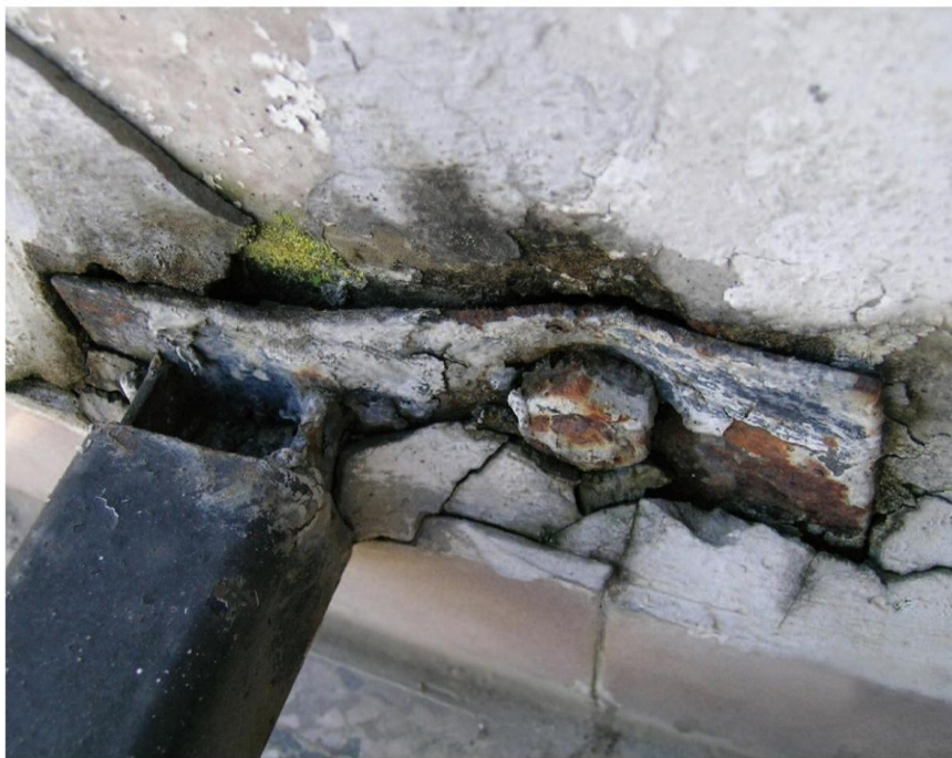
Obr. 1 – Nevhodné kotvení zábradlí a jeho důsledky
