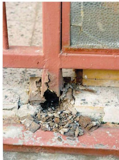
Obr. 2 – Zkorodovaný sloupek zábradlí
