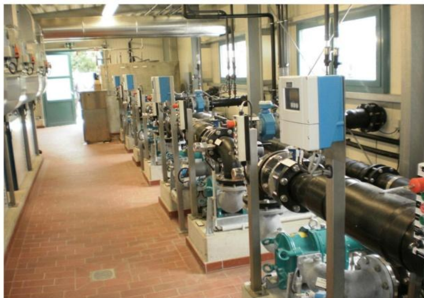
Strojovna – sací čerpadla permeátu
