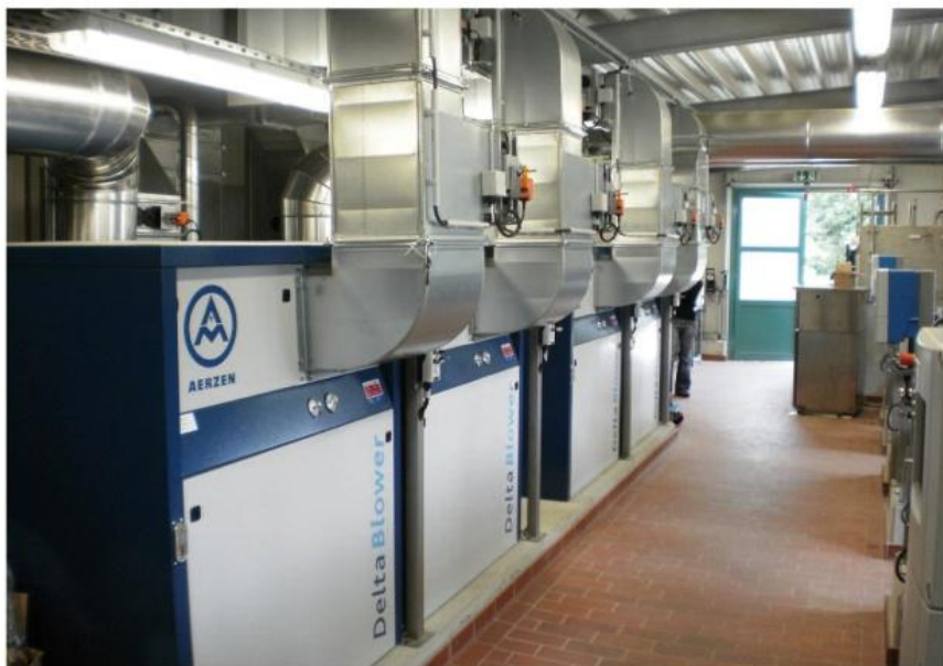
Strojovna – pohled na dmychadla
