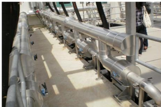
Rozvody vzduchu do aktivace
