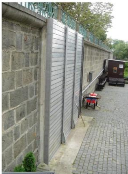
Obr. 3 – Hrazení průjezdu ve Smetanově nábřeží
