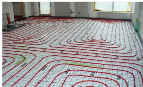
Podlahové vytápění pod keramickou dlažbou v rodinném domě
