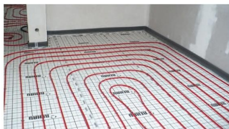
Podlahové vytápění pod dřevěnou podlahou v rodinném domě
