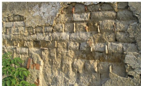
Obr. 2 – Keramické úlomky ve spárách hliněného zdiva pro zvýšení přídržnosti omítky
