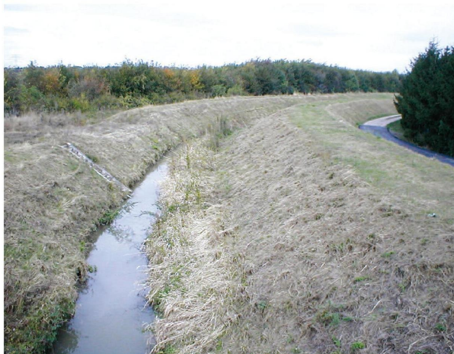
Obr. 1 – Nevhodná úprava toku mimo intravilán – původně úprava v zemědělské oblasti, dnes nevyužíváno, polní tratě zarůstají náletem, zbytečně vysoká ochrana pozemků. Foto: M. Šlezinger – oblast Moravského pole 2005
