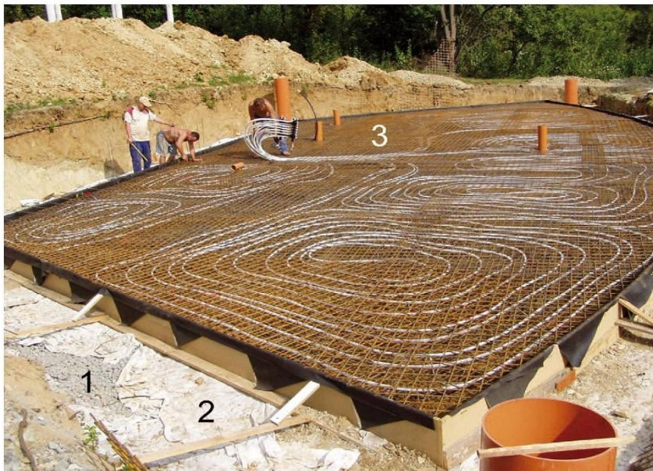
Obr. 1 Brno-Bystrc – úprava základové spáry tepelně izolační vrstvou z drčeného pěnového skla 1 – granulace pěnového skla, 2 – geotextilie, 3 – výztuž železobetonové desky.
