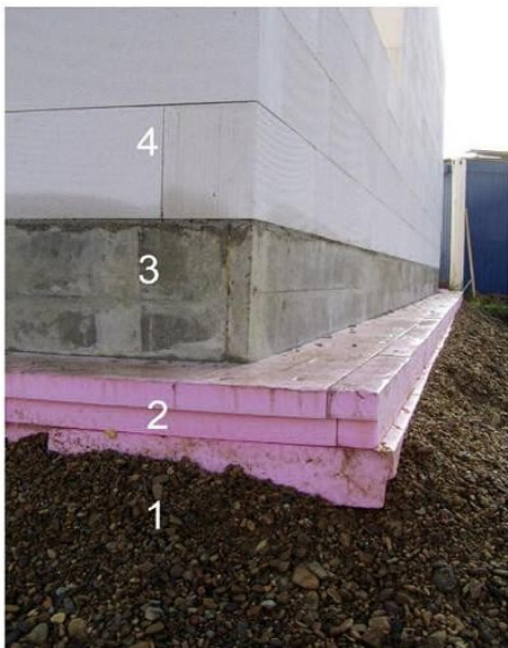
Obr. 2 Židlochovice – detail založení rodinného domu 1 – násyp, 2 – tepelná izolace z XPS tl. 200 mm, 3 – železobetonová základová deska tl. 300 mm, 4 – zdívko z párobetonových tvárníc. Autor: Ing. Petr Mareček Foto: Josef Chybík
