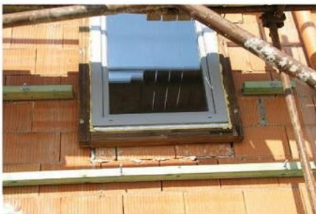
Obr. 6 – Dřevohliníkové okno s otevíravým a vyklápěcím křídlem – osazení do vrstvy tepelné izolace vnějšího zateplení pomocí dřevěných hranolů
