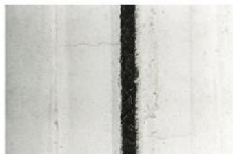
Obr. 2 – Svislá spára objektu TO6B se zdegradovaným tmelem na bázi asfaltu
