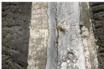
Obr. 10 – Trhliny v butylkaučukovém tmele
