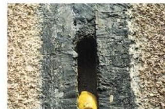
Obr. 5 – Vypadnutí tvrdé spárové výplně ze spáry
