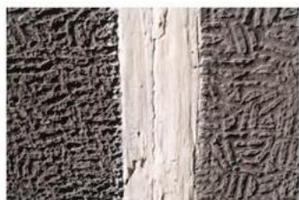
Obr. 6 – Trhliny ve tvrdé závlivce spáry
