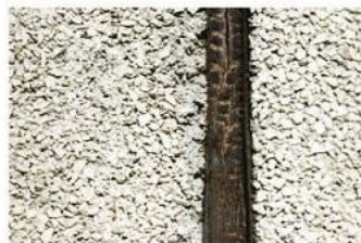
Obr. 4 – Trhliny v butylkaučukovém tmele
