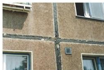
Obr. 8 – Trhliny v naneseném tmele (butylkaučuk)
