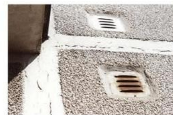
Obr. 9 – Trhliny v akrylátovém tmele
