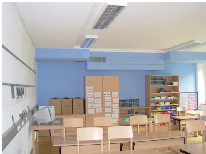
Příklad decentrální větrací jednotky – Základní škola v rakouském Hörbranz (Drexel und Weiss)
