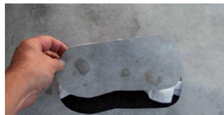
Obr. 12 – Fólie PVC kontaminovaná asfaltem
