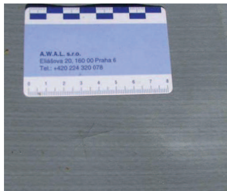
Obr. 6 – Trhliny v syntetické fólii, v počátečním stádiu vývoje
