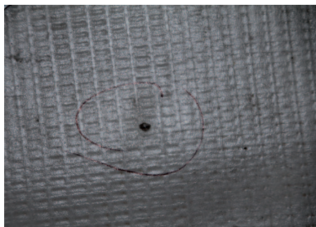
Obr. 3 – Detailní pohled na fólii s lokální poruchou (vypadlým kusem vrchní části stabilizované fólie)
