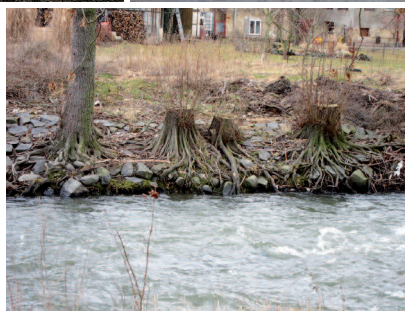
Biotop s funkcí polosuchého poldru v Dolních Břežanech. Provizorní zpevnění břehů Nisy.
