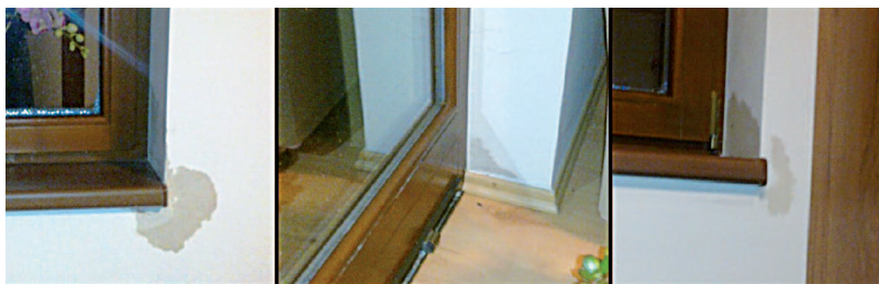
Obrázek č. 2: Následek absence vnitřního a vnějšího uzávěru připojovací spáry.
