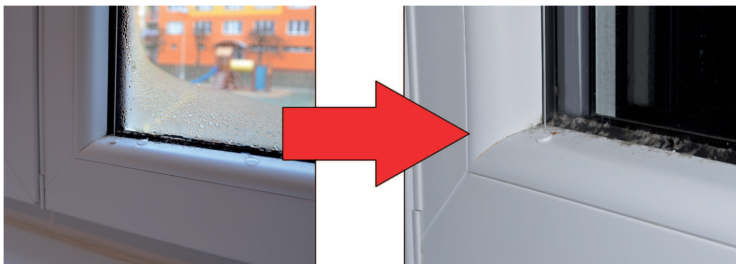
Obrázek č. 1: Následek přítomnosti kondenzátu na plastových konstrukcích - vznik plísní.
