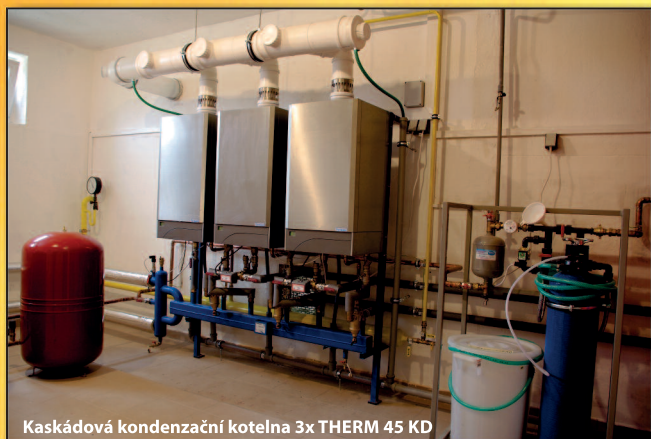
Kaskádová kondenzační kotelna 3x THERM 45 KD
