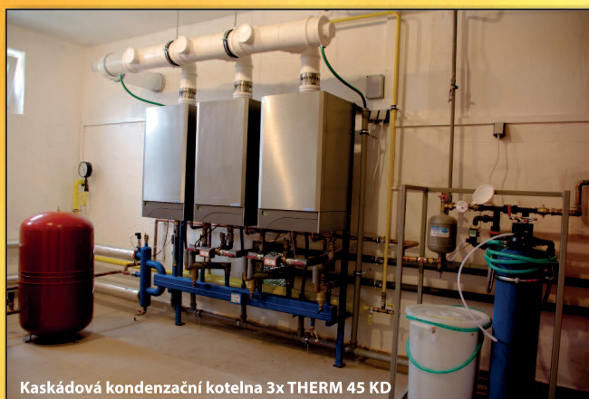
Kaskádová kondenzační kotelna 3x THERM 45 KD
