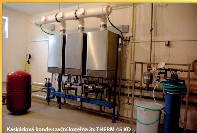
Kaskádová kondenzační kotelna 3x THERM 45 KD
